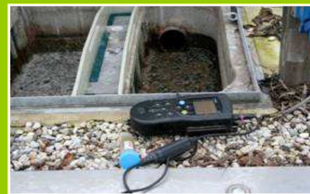
Pozzetto entrata FSO
