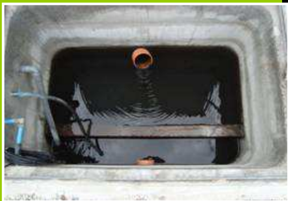
Pozzetto uscita FSO
